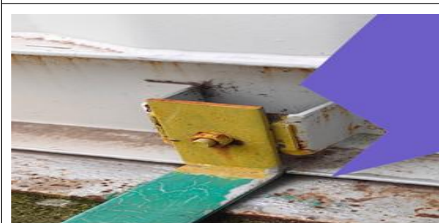
变压器接地线面积不足
