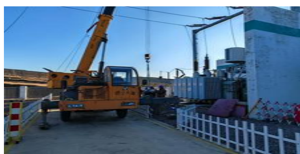
变压器套管漏油
