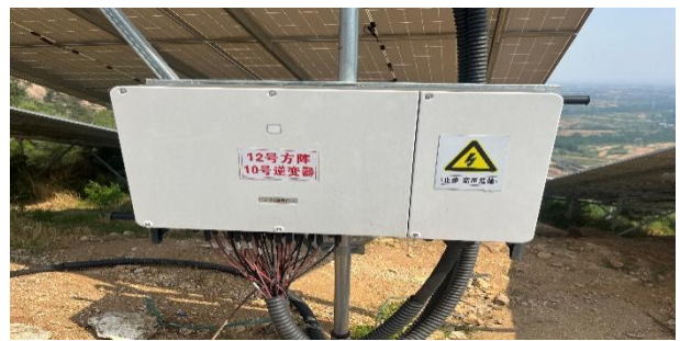
光伏逆变器安装正常
