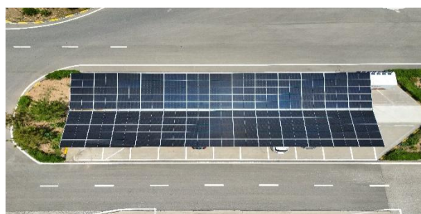
某服务区车棚光伏
