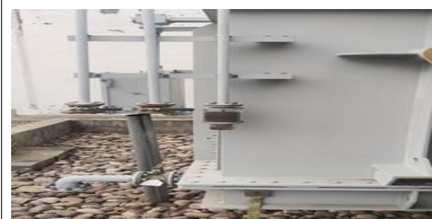
变压器呼吸器硅胶变色
